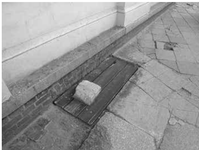
Fot. 15. Pozostałości po kradzieży metalowych kratki w budynku dworca kolejowego Wrocław Świebodzki Źródło: fot. M. Smolarski.
