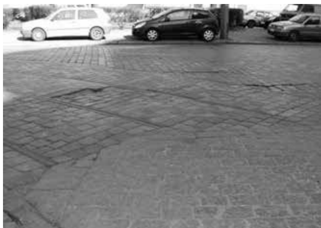
Fot. 42. Nieużywane tory tramwajowe na placu Rozjezdny Źródło: fot. A. Karaś.
