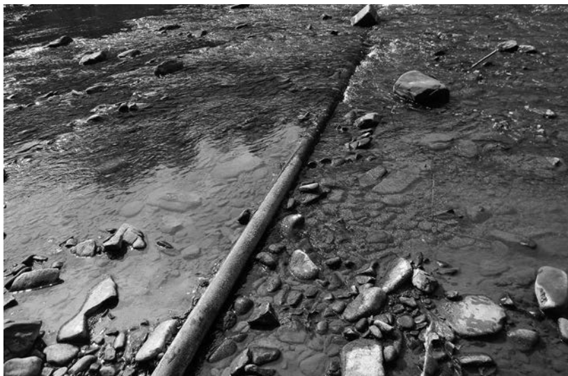
Ryc. 3. Odsłonięty wodociąg w korycie na skutek erozji wgłębnej Skawy. Stan z sierpnia 2013 r. (fot. P. Głuszek)
